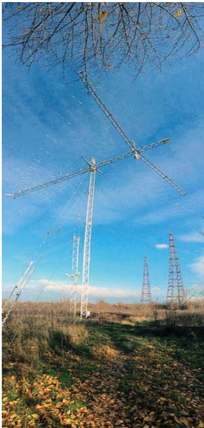
Saftica/Romania 100 kW transmitter for Radio España Independiente 1956-1977
